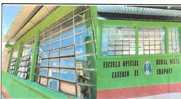
Foto 4: se realizará el cambio de ventanales, debido a que se encuentran en malas condiciones.
