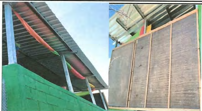
Foto1: se realizara pared de blook, debido a que el aula no cuenta con una parte de pared.
